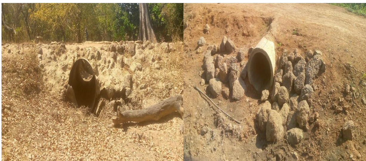
Photo 5: Aperçu de buse métallique au pk 7 + 510 et de Buse en Béton armé au pk 24 +280 (A remplacer par un dalot)
