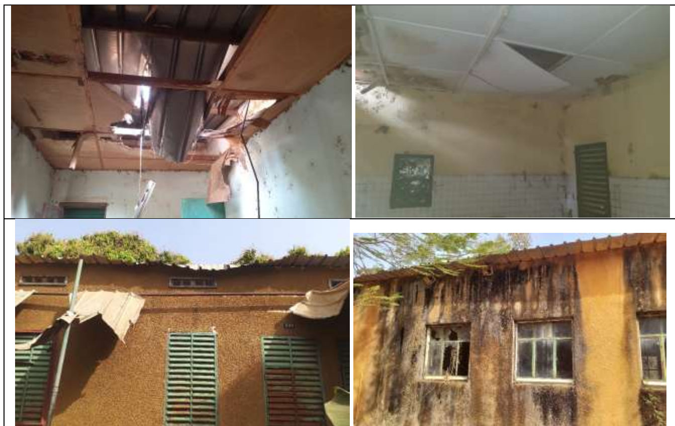
Photo 7 : Vue des parties dégradées des bâtiments du site identifié pour servir de base-vie
